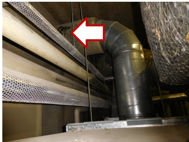
防火ダンパーに吊り金具が設けられていない事例
