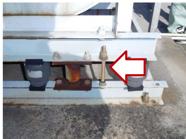
排気機の取付け部分の腐食事例（写真では運搬時の仮固定ボルトで免震装置が固定されてしまっている。）
