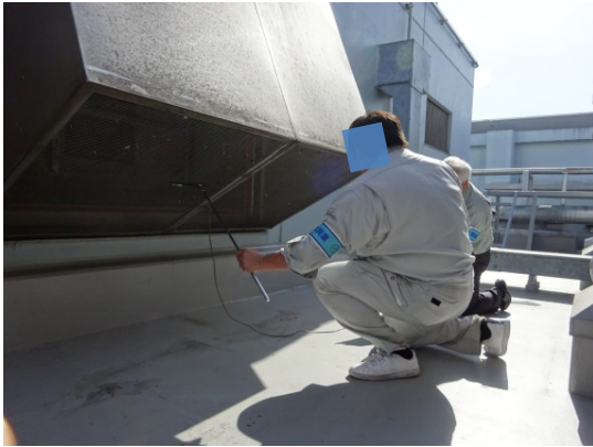
煙排出口の風速測定状況
