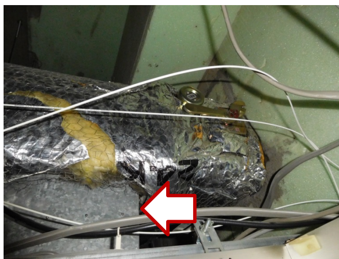
断熱材の欠損事例
