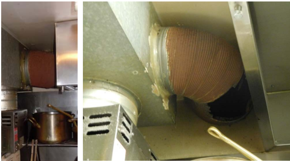
排気筒の破損事例
