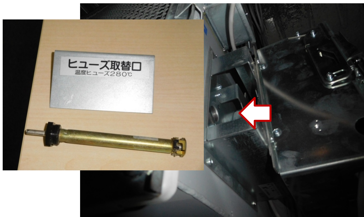
ヒューズ取替口の例
