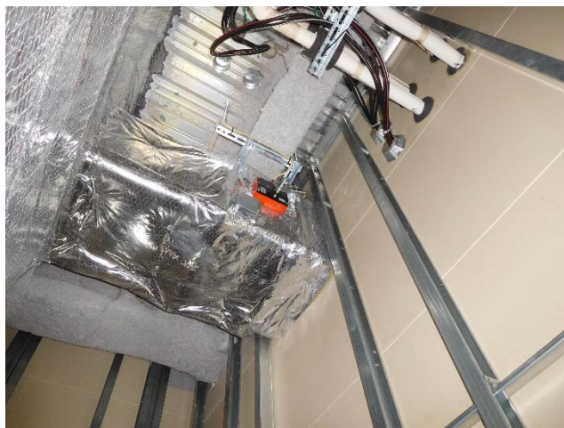
天井内に設けられた防火ダンパーの例
