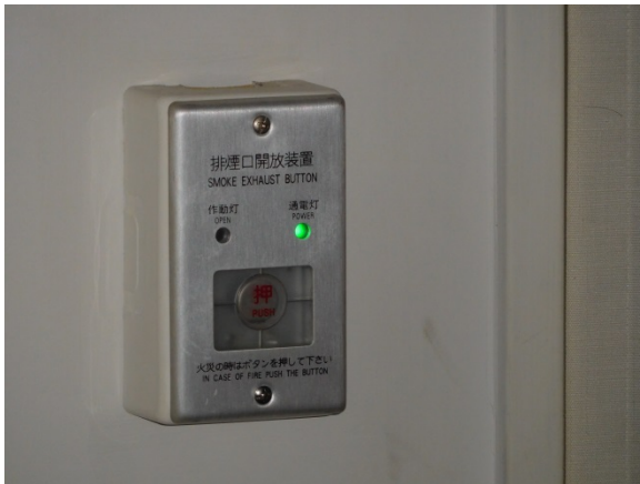
排煙口開放装置の例
