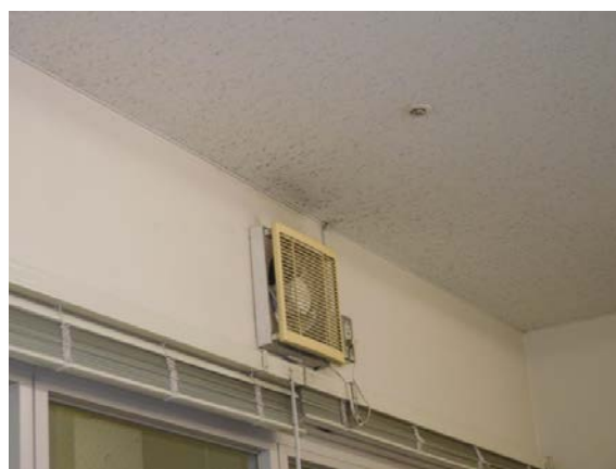
大規模な事務所ビルに換気扇が設けられている事例
