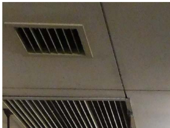
給気口と排気口が近接している事例
