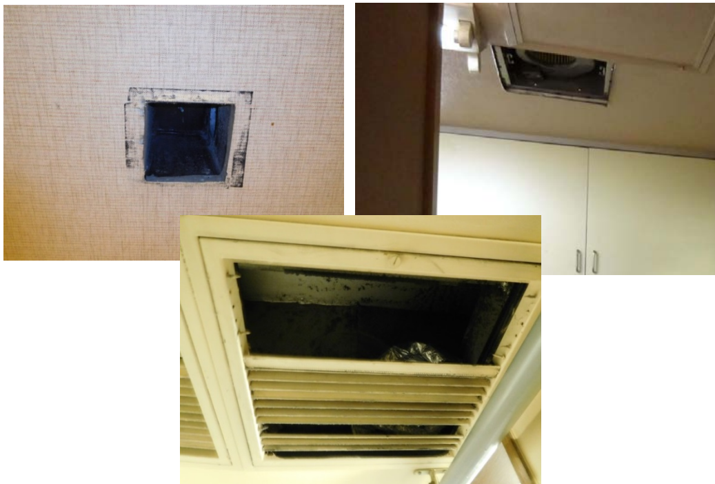
排気口の損傷事例
