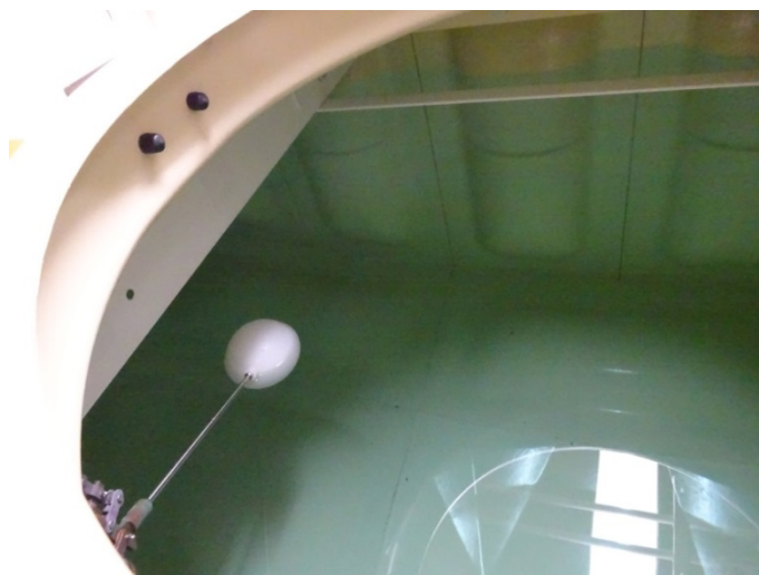
飲料水用給水タンクの内部の例
