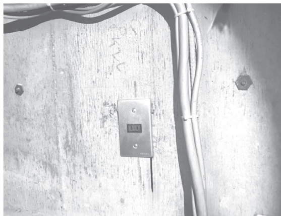
写真-1 点検用コンセント
