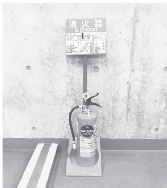
写真-3 消火設備
